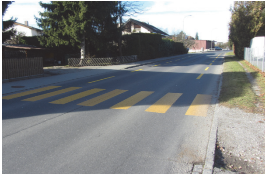
Fehlender Fussweg und mangelhafter Fussgängerübergang auf Pfanderstrasse
