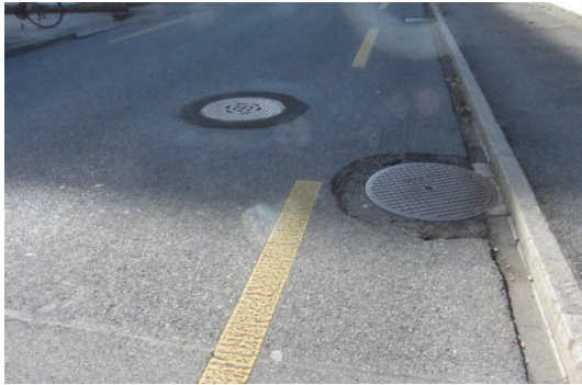
Schorenstrasse: Einlaufschächte auf dem schmalen Velostreifen
